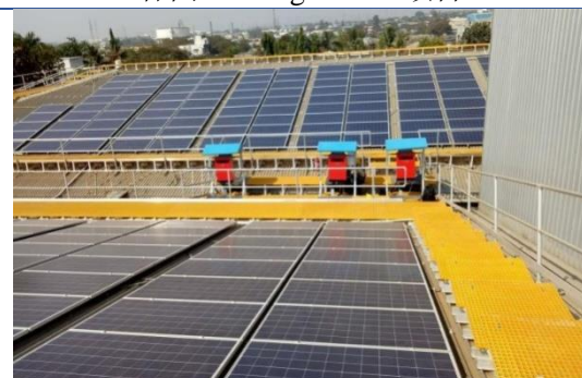
西门子 5MW 项目
