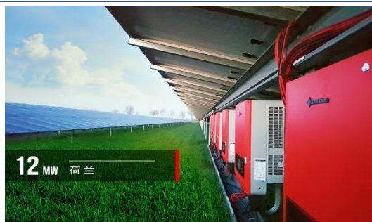
荷兰鹿特丹 12MW 项目
