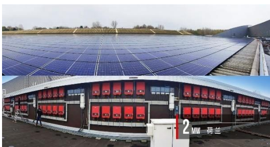
荷兰 2MW 项目
