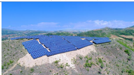
中国河南洛阳 25MW 项目
