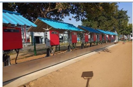
博世 4MW 项目
