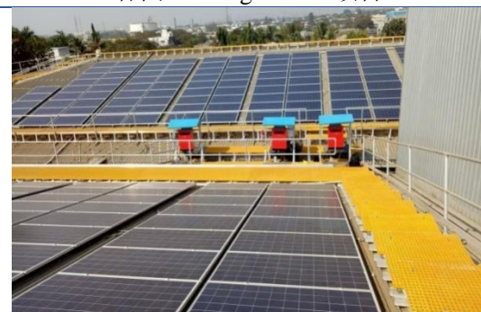
西门子 5MW 项目
