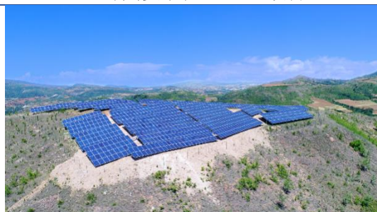
中国河南洛阳 25MW 项目
