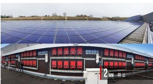
荷兰 2MW 项目
