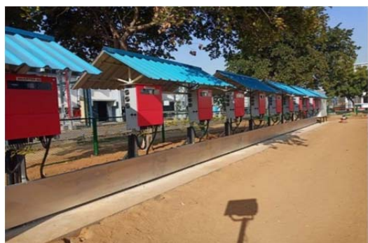
博世 4MW 项目
