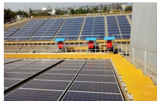
西门子 5MW 项目
