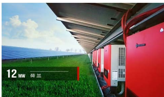
荷兰鹿特丹 12MW 项目
