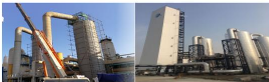
天安化工 5.2 万 Nm 3 /h 深冷空分装置
