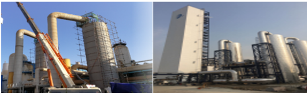
天安化工 5.2 万 Nm 3 /h 深冷空分装置
