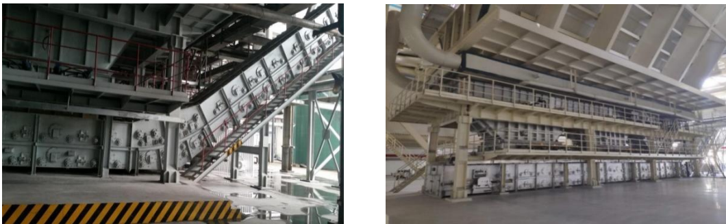
干式炉渣处理系统实景图
