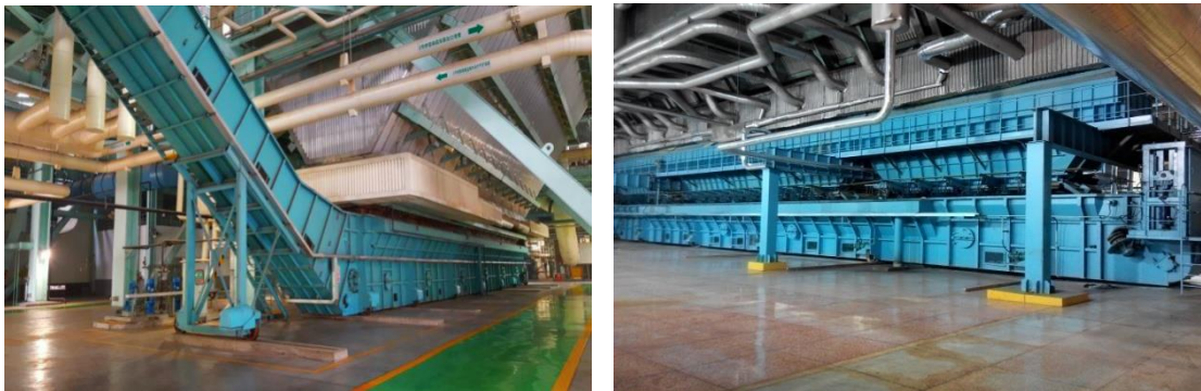
湿式炉渣处理系统实景图
