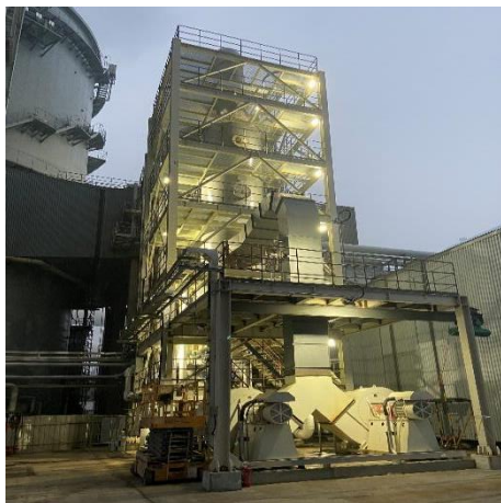
脱硫废水环保处理系统实景图
