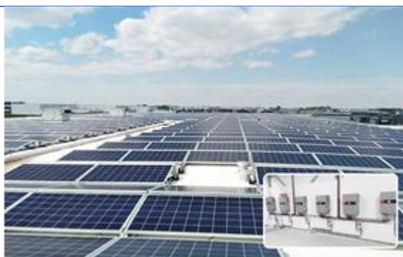
荷兰工商业光伏项目
