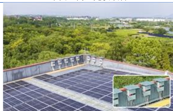
中国光伏整县推进项目
