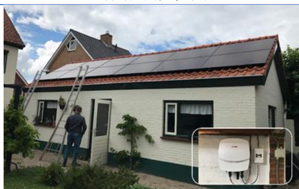
荷兰户用光伏项目
