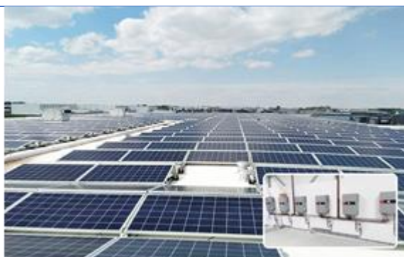
荷兰工商业光伏项目
