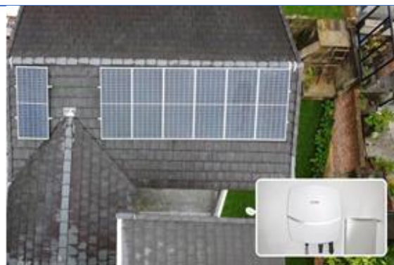
马来西亚户用光伏项目
