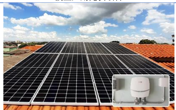
巴西户用光伏项目
