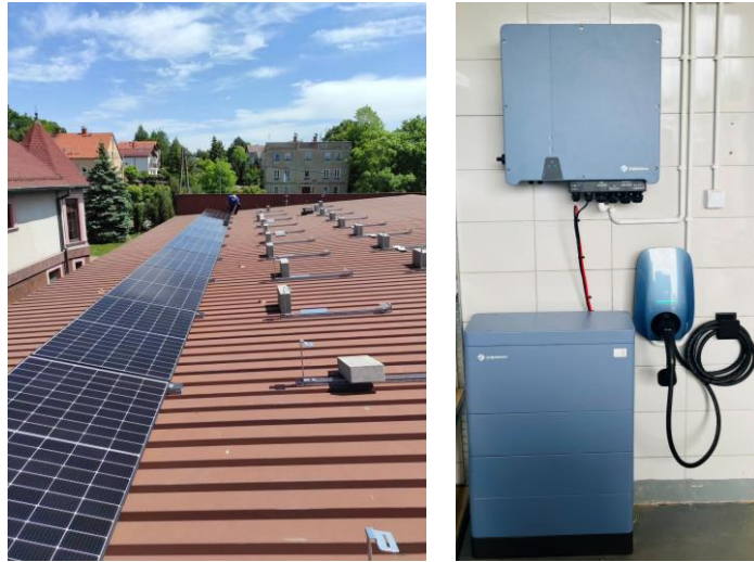
波兰“光-储-充”一体化项目
