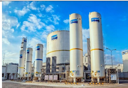
深圳现场制气项目
