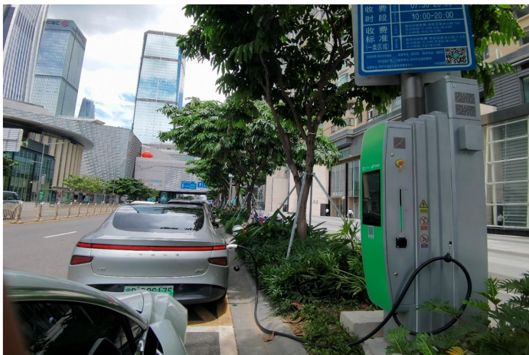
位于深圳的电能“储充一体”示范项目
