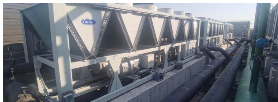
● 公司在建项目空气源热泵
