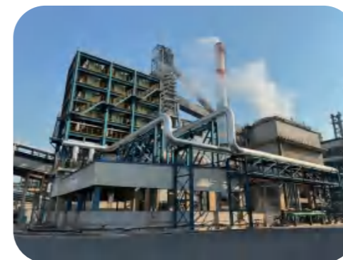
高炉冲渣水余热换热系统
