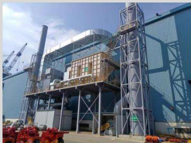
涂装自动化生产线配套废气处理设备
