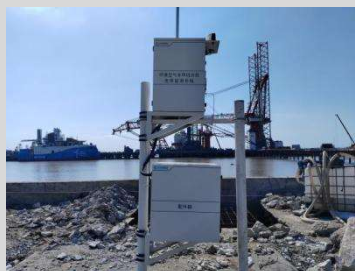
厂界环境空气非甲烷总烃连续监测系统
