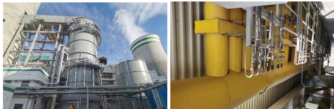
锅炉机组配套脱硫系统
