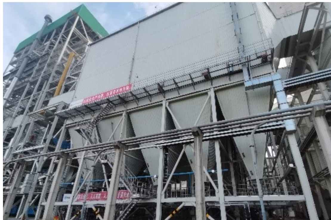
锅炉机组配套双室五电场除尘器
