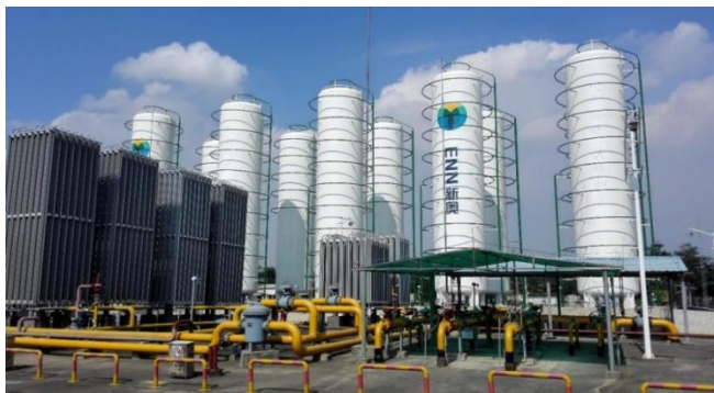
公司天然气厂站
