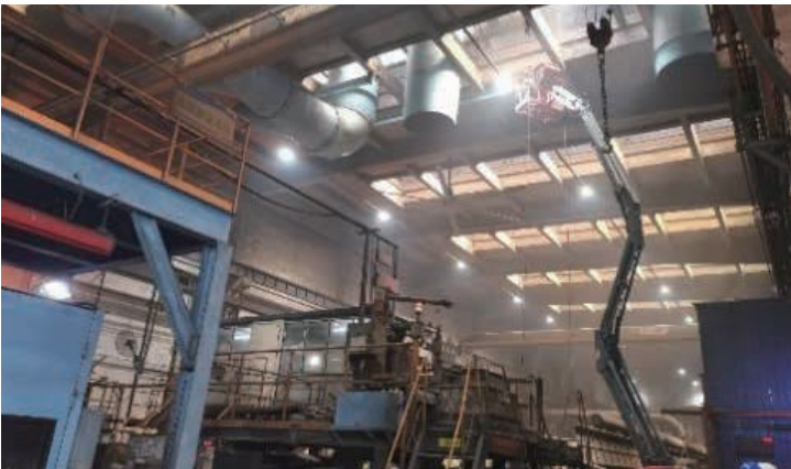
垂直车间整体除尘项目
