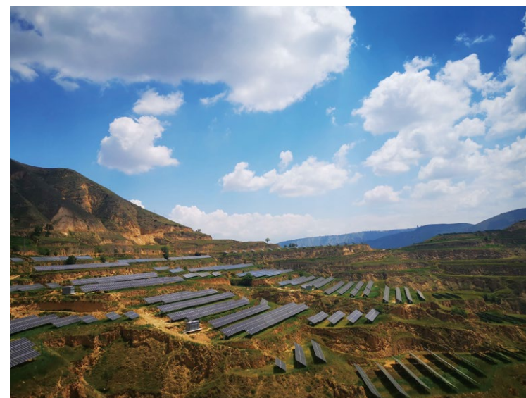
④ 东乡光伏发电项目
