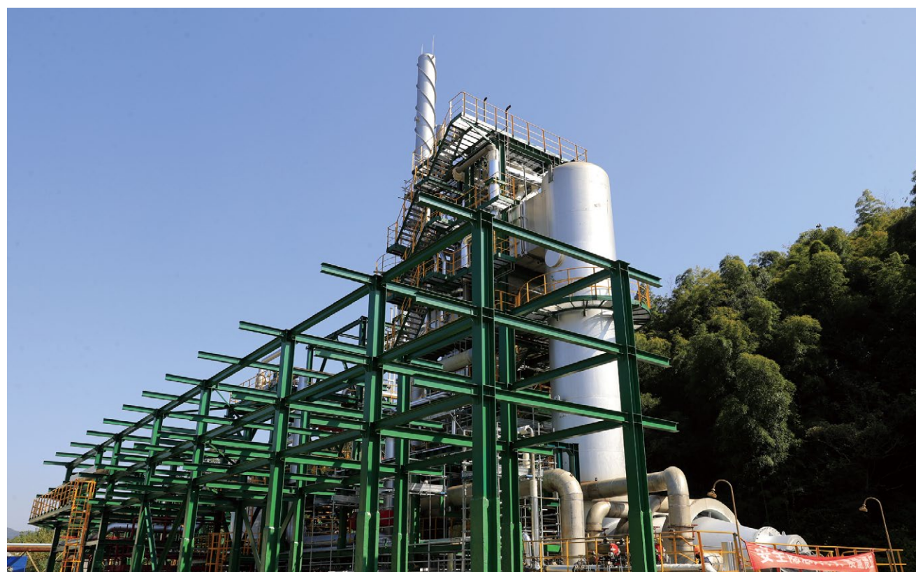
④ 巴陵石化新建成环己酮装置挥发性有机污染物 (VOCs) 治理项目
