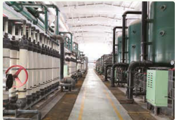
循环水排污水处理系统
