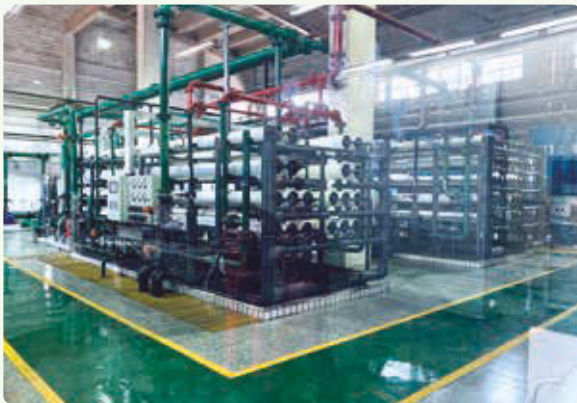
锅炉补给水处理系统
