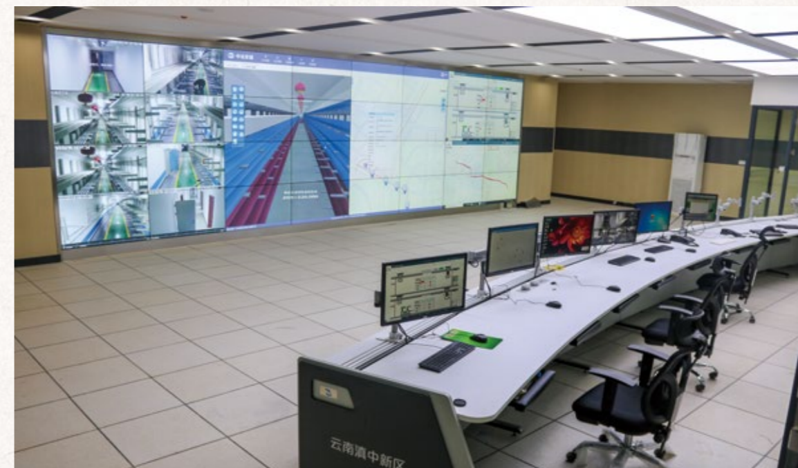
滇中新区智慧管廊监控大厅
