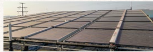
施工现场集热式太阳能热水器
