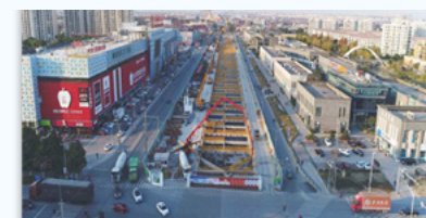
轨道交通 18 号线工程 工程性质：上海市重大工程 项目金额：4.5 亿元
