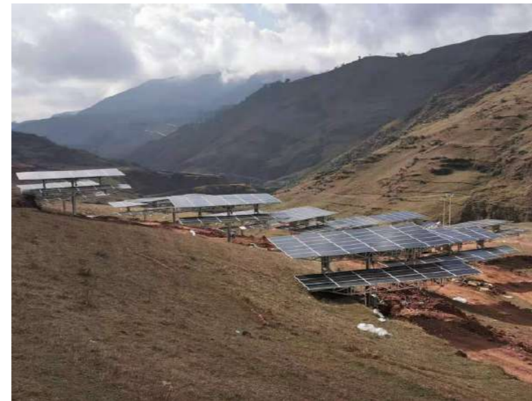
昭觉村级光伏扶贫电站
