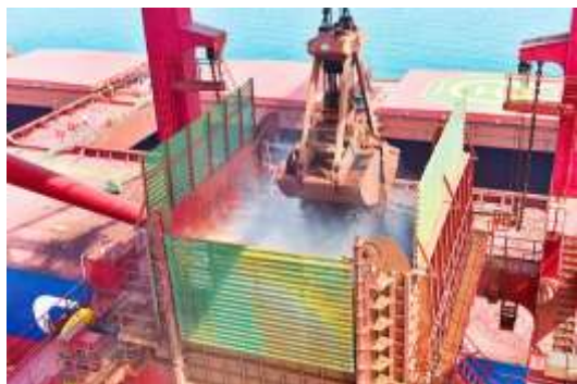
卸船机自动化抑尘系统
