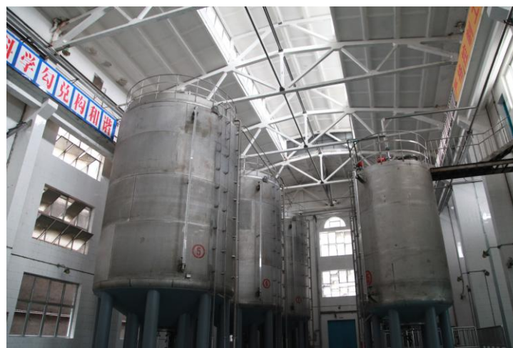
大罐勾调系统
